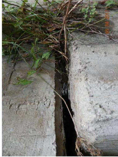
Foto 6. Aparelho de apoio em neoprene rompido/deteriorado.
