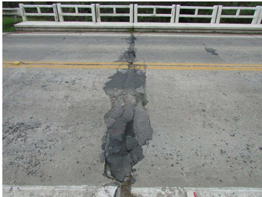
Foto 88 Visão geral da junta de dilatação da cabeceira do encontro Sul da ponte – sobre projeção da linha de apoio 10 – apresentando desagregação do pavimento rígido, sem vedação de juta e com reparos inadequados em massa asfáltica.
