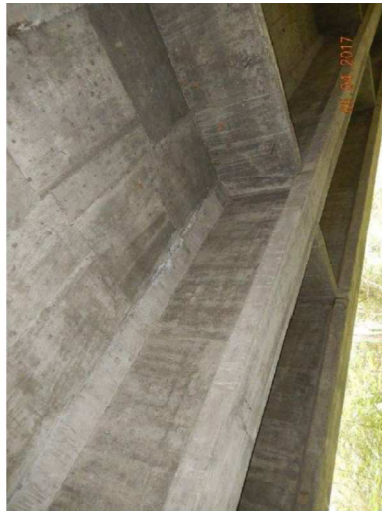
Foto 5. Fissura com efflorescência na interface laje / viga longitudinal.
