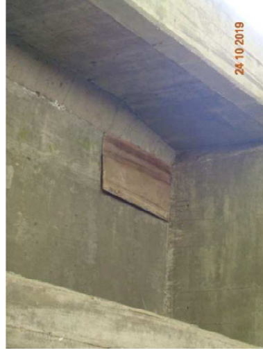
Foto 4. Restos de fôrma na laje.
