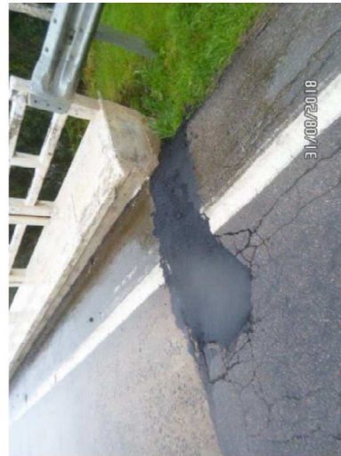
Foto 7. Buraco no pavimento asfáltico reparado na região do encontro. Nota-se falha no procedimento adotado.
