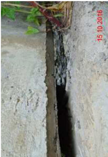
Foto 5. Aparelho de apoio em neoprene rompido/deteriorado.
