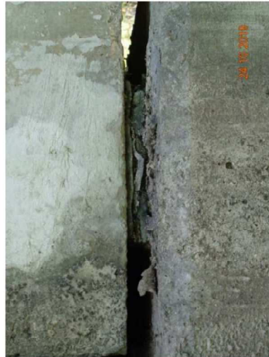
Foto 5. Aparelho de apoio em neoprene deformado.
