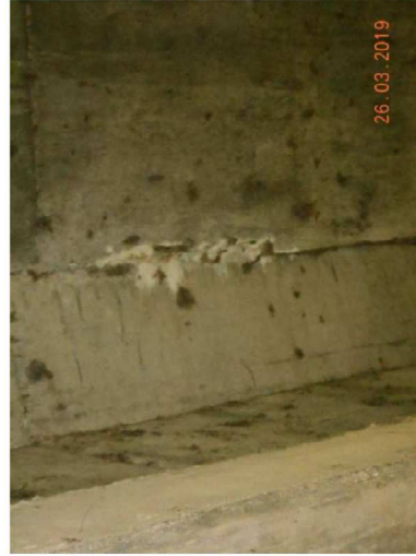
Foto 4. Fissura com efflorescência na laje.
