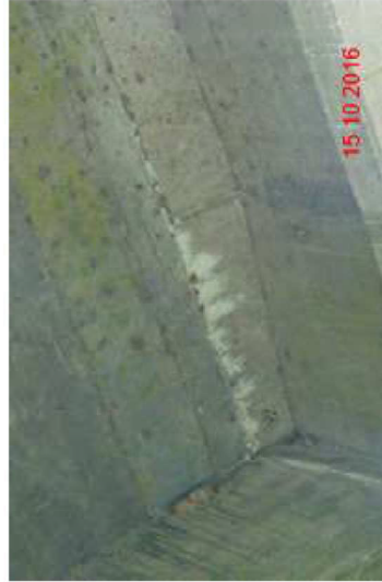
Foto 6. Fissura com efflorescência na laje - face inferior.
