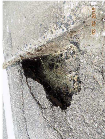
Foto 7. Buraco no pavimento asfáltico na região do encontro.
