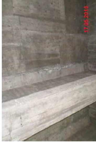
Foto 6. Fissura com efflorescência na laje - face inferior.
