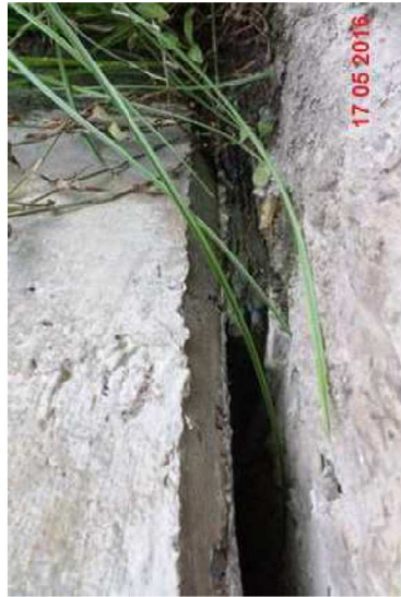
Foto 5. Aparelho de apoio em neoprene rompido/deteriorado.
