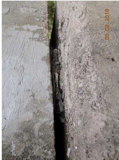
Foto 5. Aparelho de apoio em neoprene rompido/deteriorado.
