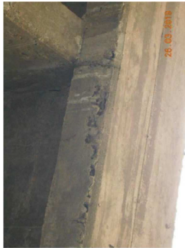
Foto 5. Concreto segregado com armadura exposta e corroída na viga longitudinal.
