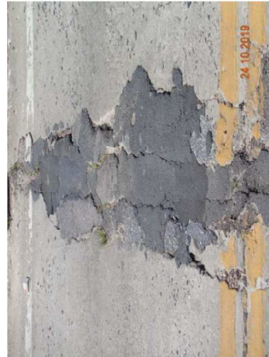
Foto 7. Idem foto anterior – Detalhe para ruptura da junta de dilatação.
