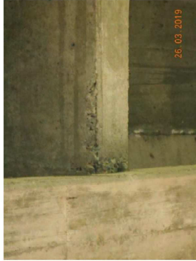
Foto 6. Concreto segregado com armadura exposta e corroída na viga transversina.
