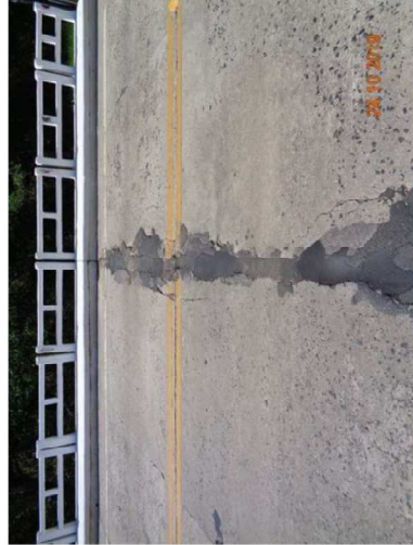
Foto 6. Junta de dilatação recoberta por capa asfáltica e rompida.
