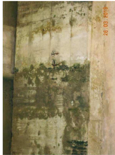
Foto 7. Concreto segregado com armadura exposta e corroída na viga travessa.
